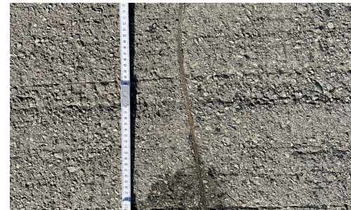
Skal Å (1987) - Revner
